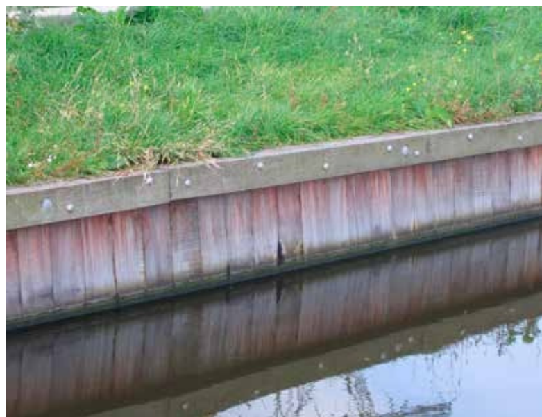
Damwand van tropisch hardhout
